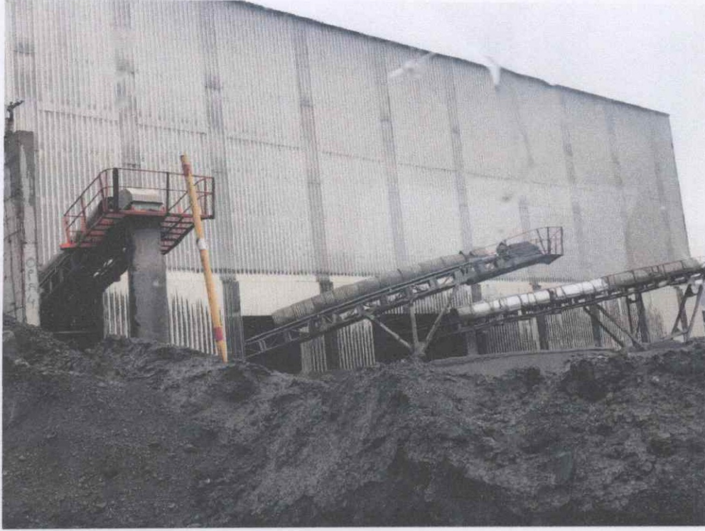
Görsel-9: Kırma-Eleme Tesisi Bant Kapamaları
