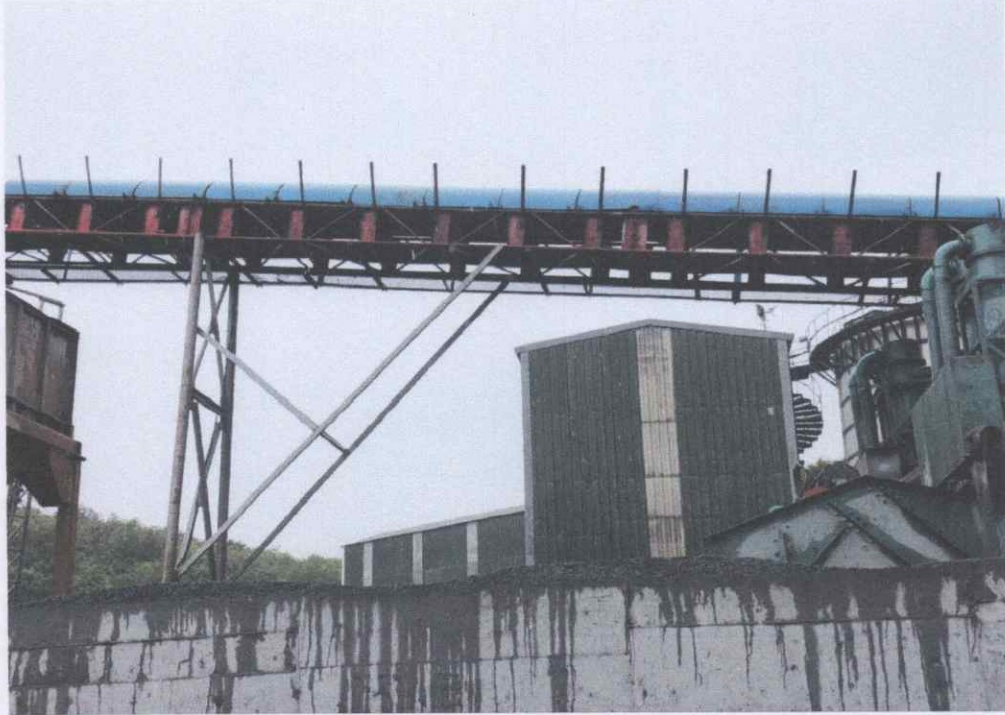
Görsel-8: Kırma-Eleme Tesisi Bant Kapamaları
