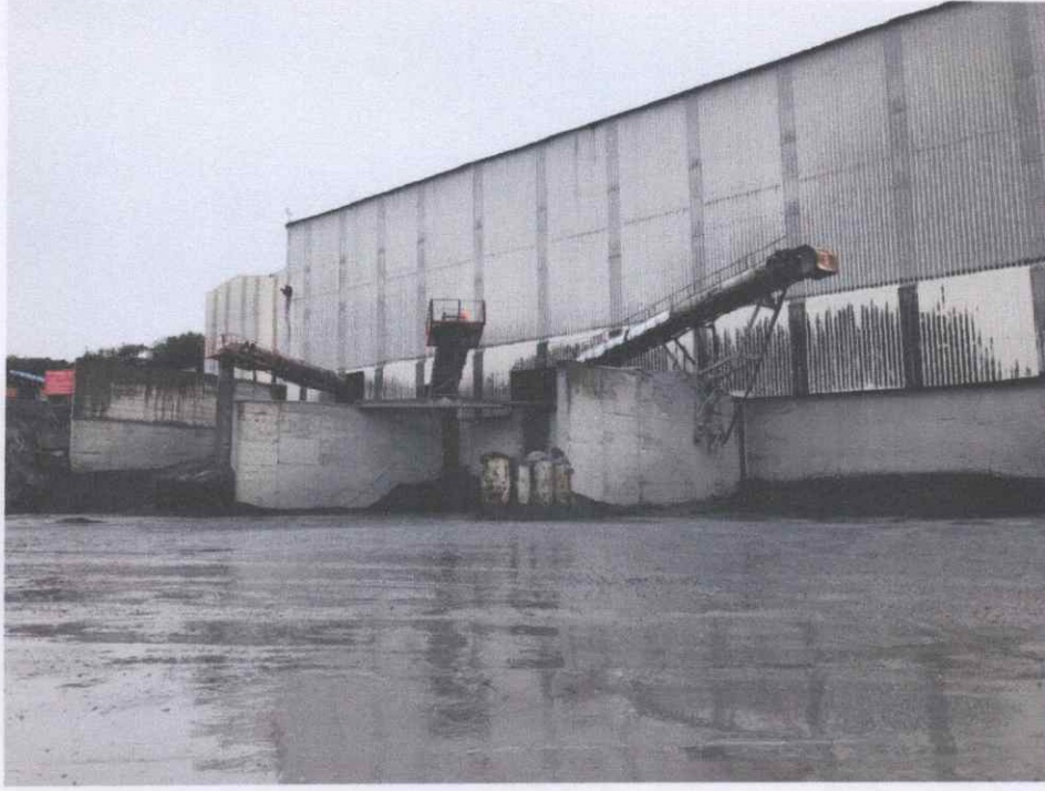
Görsel-5: Kırma-Eleme Tesisi Bant Kapamaları
