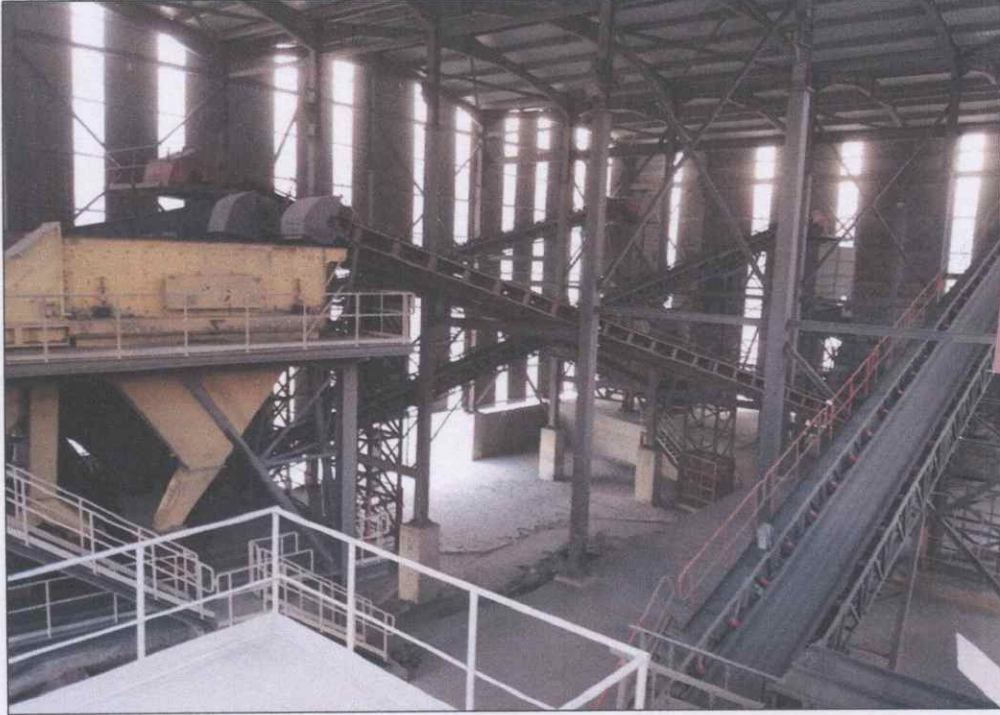
Görsel-14: Kırma-Eleme Tesisi İç Görünüm(Kapalı Alan)
